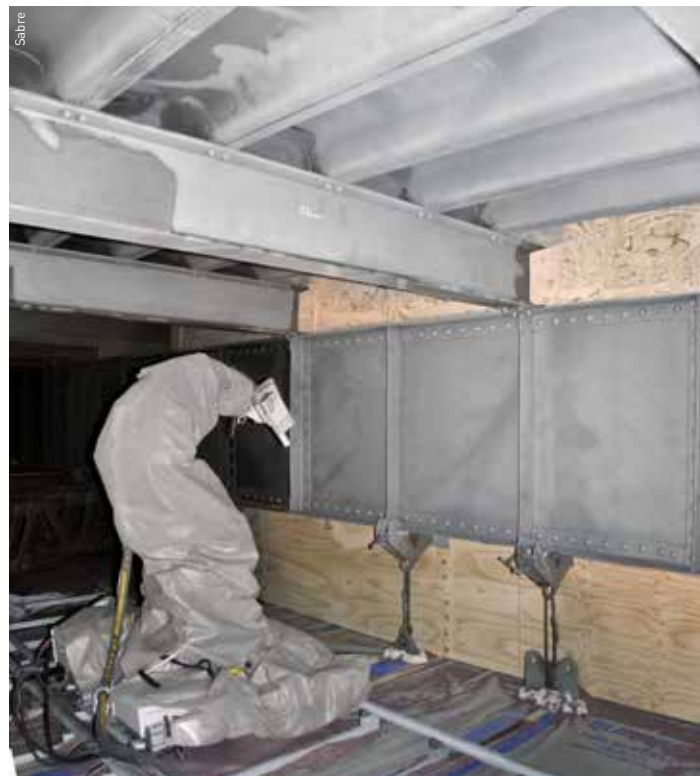
Der Sandstrahlroboter der Sabre Autonomous Solutions fräst völlig autonom Schmutz, Rost und alte Farbe von Stahlträgern. Ein Kinect Sensor und spezielle Algorithmen berechnen ein Mapping-System für den exakten Bahnverlauf der Sandstrahlpistole und verhindern so Kollisionen.
